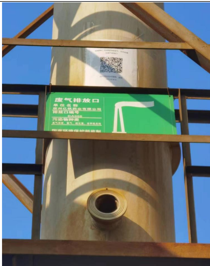
污水处理站废气排气筒标识牌 (DA006)
